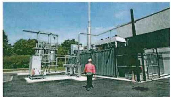
Bâtiment de cogénération de l'UVO
