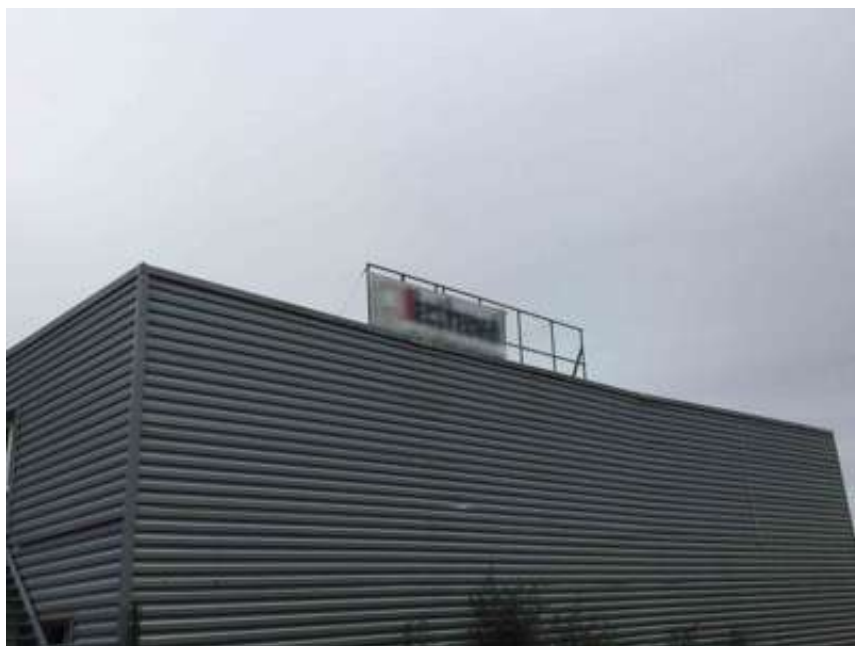
Enseigne sur toiture ou terrasse en tenant lieu réalisée sans lettres découpées et en mauvais état d'entretien – Rue Alain Gerbault, Vannes
