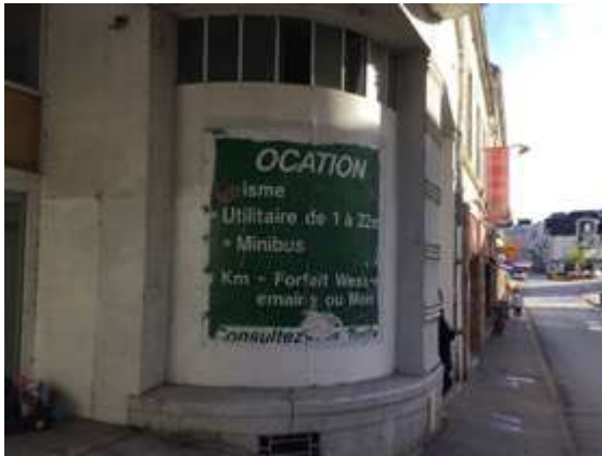
Publicité apposée au mur en mauvais état d'entretien - Art. R. 581-24 C. env. - rue du Maréchal Leclerc, Vannes
