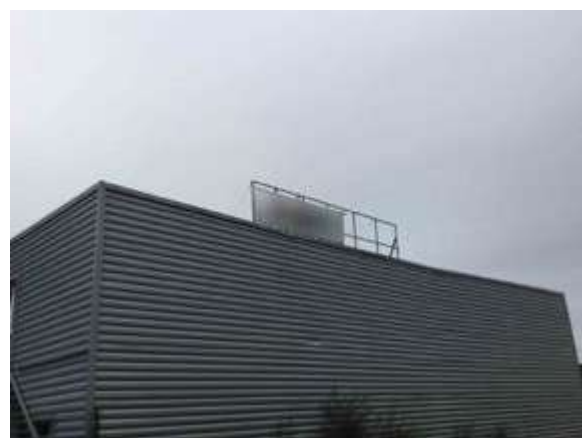
Enseignes sur toitures réalisées avec un panneau de fond et en mauvais état d'entretien – infractions au code de l'environnement – Rue Alain Gerbault, Vannes
