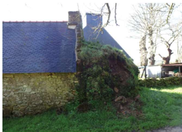
Un ancien four à pain se trouve à l'arrière. Il est très abîmé et mériterait d'être restauré.
