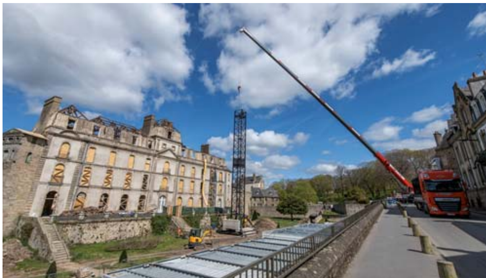
Il a fallu deux jours pour installer une grue démontable devant l'Hôtel Lagroce.
